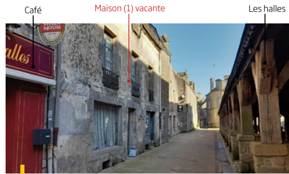
Au centre de la rue, les deux vitrines vacantes et dégradées
