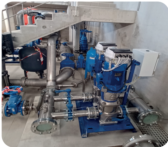
surpresseur du réservoir de Kerguéro vitesse variable - Brec'h
